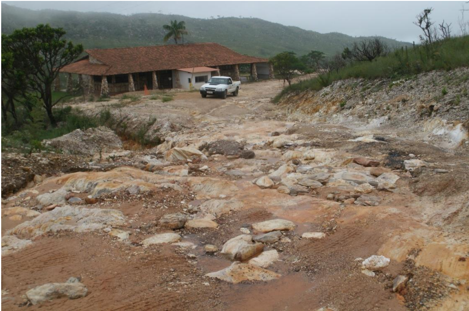
Figura 8 - Trecho da estrada próxima ao Centro de Visitantes, em 2015.
