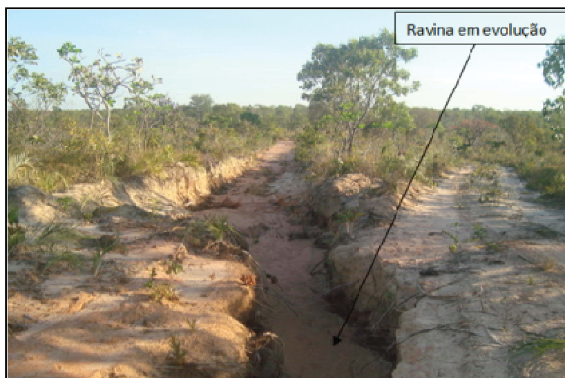
Figura 83 - Abertura de estradas, uma ao lado da outra, com formação de voçorocas em processo evolutivo na porção nordeste do entorno da Estação Ecológica Serra Geral do Tocantins. Fonte: Cristo (2013b).
