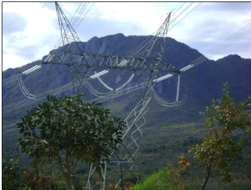
Figura 21 - Rede de transmissão de energia elétrica da UHE Serra da Mesa Autor: PRUDENTE, T.D., 2009
