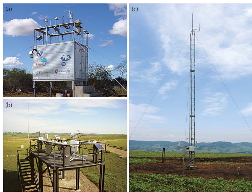
Figura 11. (a) Módulo de medidas da estação SONDA em Brasília com os sensores de radiação instalados sobre o teto; (b) Plataforma com os sensores de radiação na estação SONDA em São Martinho da Serra; e (c) Plataforma de coleta de dados
